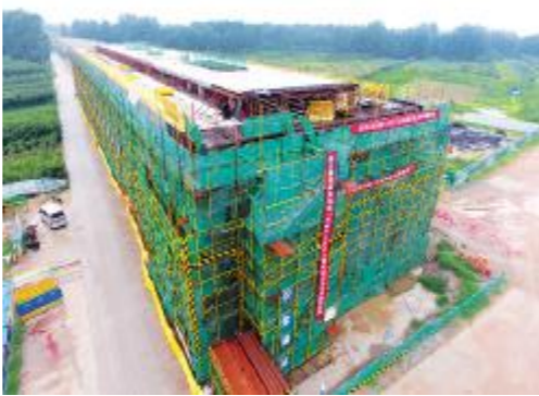
近日,由海南分公司承建的青岛地铁13号线二期工程工区中心路站顺利封顶,标志着该站主体结构完工。
