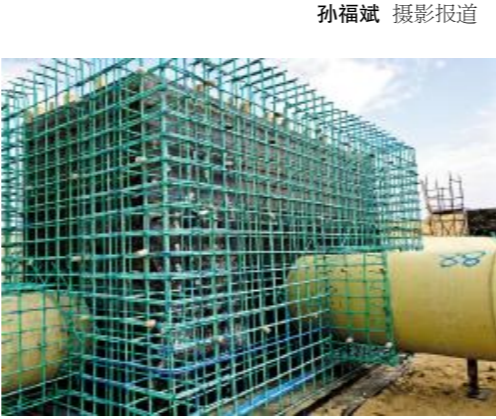
近日,由中东南分公司承建的驻马店项目完成最后一座大型海边集水井浇筑,至此驻马店项目集水井浇筑施工全部完成。
