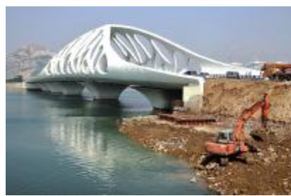
▲截至10月15日,由第二项目部承建的青岛西海岸名人岛连岛路工程,顺利完成业主指定的各节点目标,正全力向10月底竣工的目标发起冲刺。
