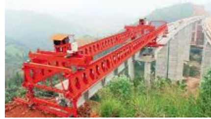
▲近日,由公司承建的云南蒙文砚高速公路灯笼山大桥最后一根T梁架设完成。该桥全长320米,共计8跨,单跨40米,重约135吨,共有T梁80根。其中最高桥墩67米,是本标段最高桥墩。
