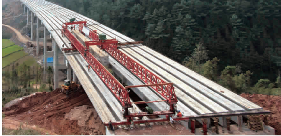
本报讯 2015年12月28日,公司承建的蒙文砚高速公路桥头大桥 T 梁架设完成,成为全线首座全面贯通的大桥。桥头大桥位于蒙自市芷村镇境内,全长 306 米,共计 10 跨,单跨 30 米,共有 T 梁 98 根。
